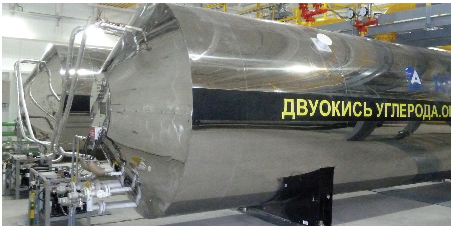
Рис. 1. Установка газового пожаротушения на базе МИЖУ
